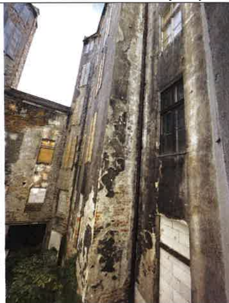
Zniszczenia ścian zewnętrznych
