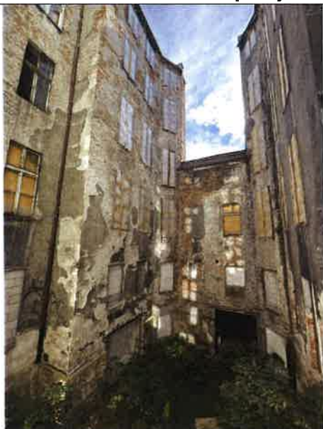
Zniszczenia ścian zewnętrznych
