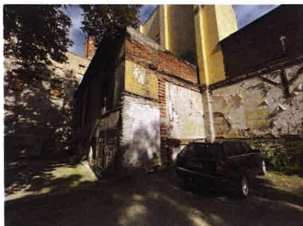
Zapadnięta konstrukcja na łączniku
