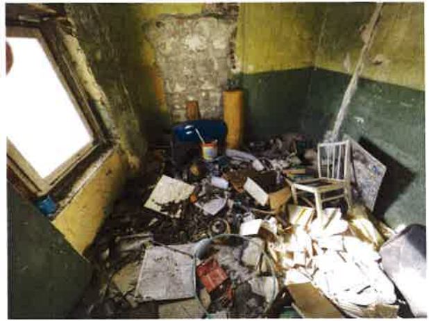
Spękany komin do rozbiórki lub zabezpieczenia
