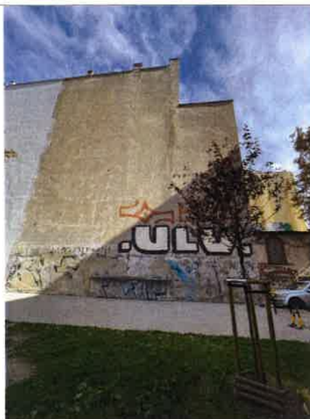
Zniszczenia ścian zewnętrznych
