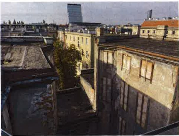
Zniszczony strop poddasza
