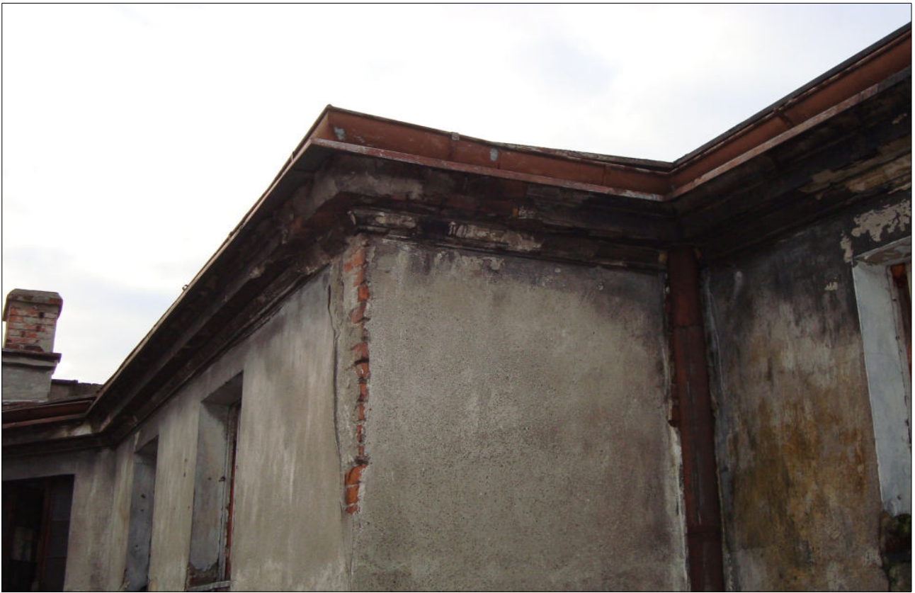
Fot. 32. Widok narożnika budynku – woda opadowa zalewa w wielu miejscach elewację budynku, brak szczelnych obróbek, pasów nad i pod rynnowych, rynny i rury spustowe także nieuszczelne, gzymsy ceglane całkowicie zdegradowane poprzez korozję biologiczną a także przez silne zawilgocenie wodą opadową.
