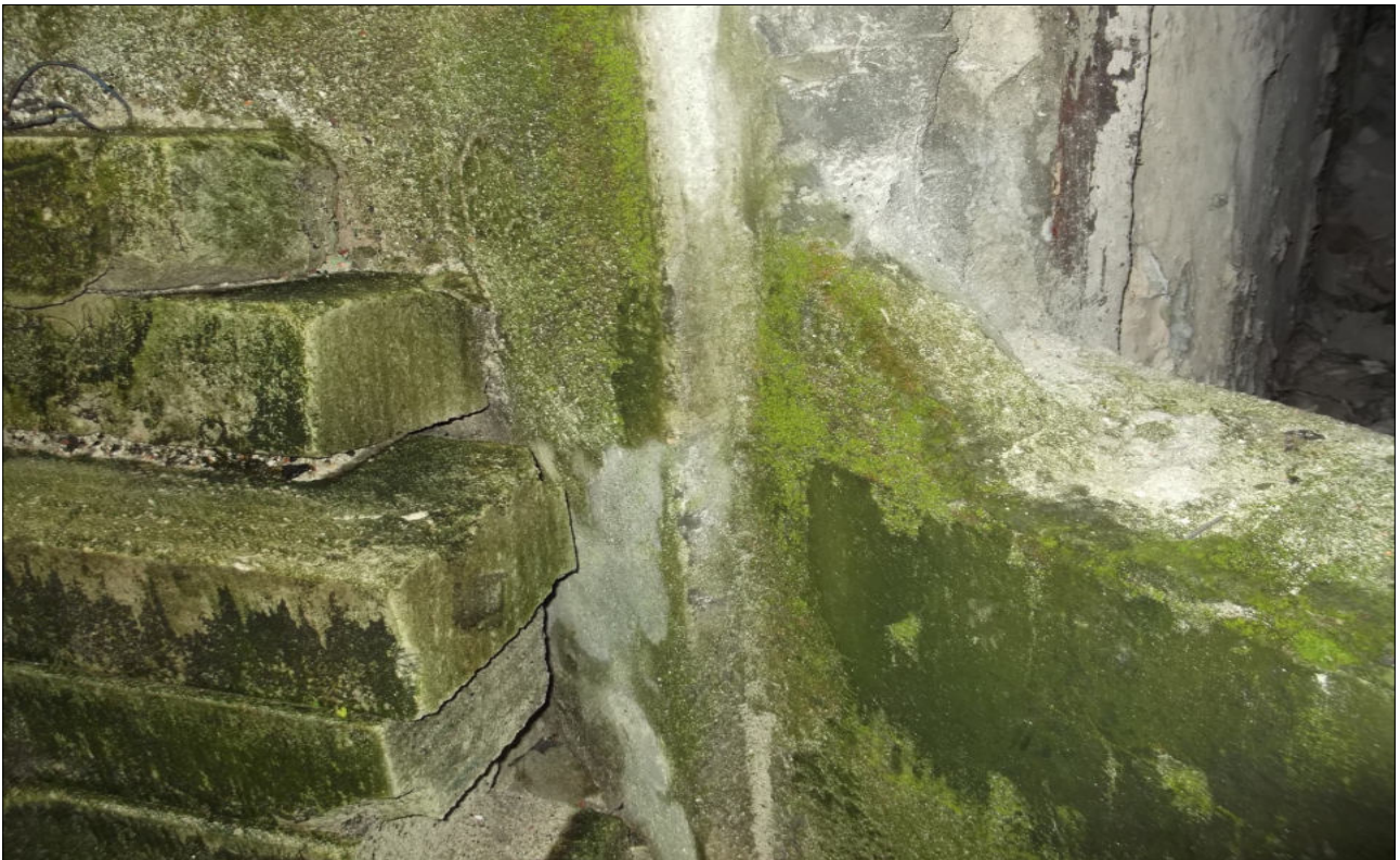
Fot. 12. Strefa przyziemia budynku – widoczna korozja biologiczna muru ceglanego, elewacja wykazuje stan mokry, widoczne wykwity glonów i zagrzybienie pleśniowe, korozja biologiczna obejmuje znaczną strefę przyziemia budynku.
