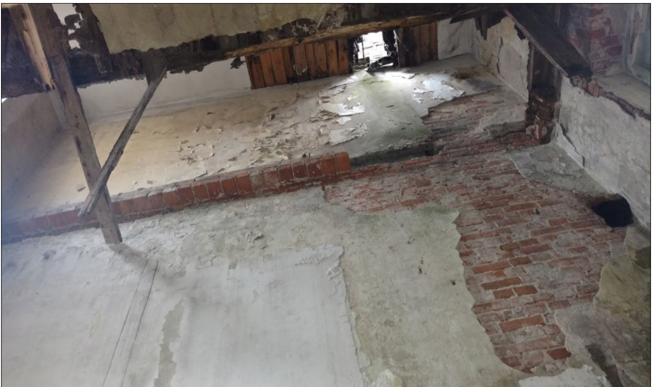
Fot. 37,38. Brak biegów klatek schodowych – demontaż konstrukcji stalowej został wykonany przez złomiarzy, brak możliwości wejścia na wyższe piętra budynku, demontaż elementów konstrukcyjnych klatki schodowej (belki podestowe) może spowodować utratę stateczności ścian nośnych klatki schodowej, brak odpowiedniego stężenia konstrukcji murów ceglanych. Pozostawione elementy klatki schodowej zagrażają życiu i zdrowiu osób tam wchodzących – niekontrolowane oderwanie się elementów od ściany czy stropu.
