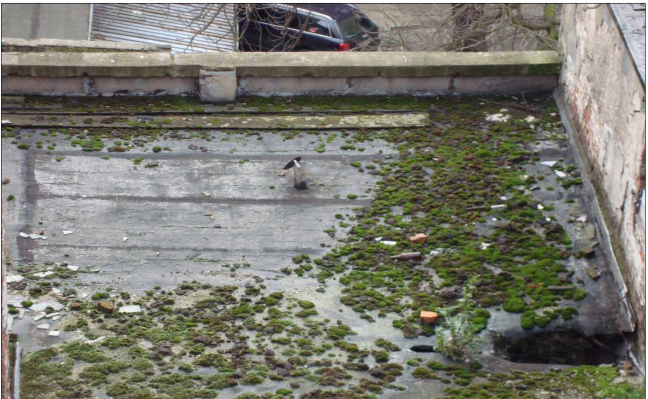
Fot. 26,27. Widok połaci dachu – całkowita degradacja papy na deskowaniu, widoczne zapadnięcia deskowania połaci, brak rynien i nieszczelne obróbki blacharskie powodują zalewania elewacji budynku, degradacja muru ceglanego, korozja biologiczna wskutek nieszczęśliwego działania wody opadowej, konieczny generalny remont konstrukcji dachu wraz z warstwami pokrycia dachowego.
