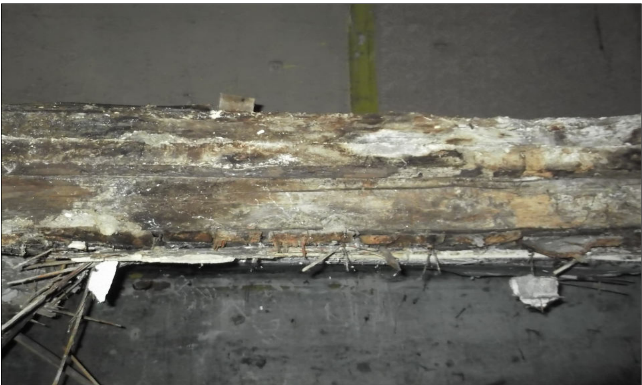
Fot. 44,45. Widok elementów drewnianych stropu – desek podsufitki i belek konstrukcyjnych, elementy porażone przez korozję biologiczną, widoczne silne zmurszenie materiału, przekrój belki nośnej zmniejszony w stosunku do zdrowej części belki, nośność elementów konstrukcyjnych wielokrotnie została obniżona. Elementy nośne stropów nadają się już tylko do rozbiórki i demontażu, brak możliwości wzmocnienia i impregnacji drewna.
