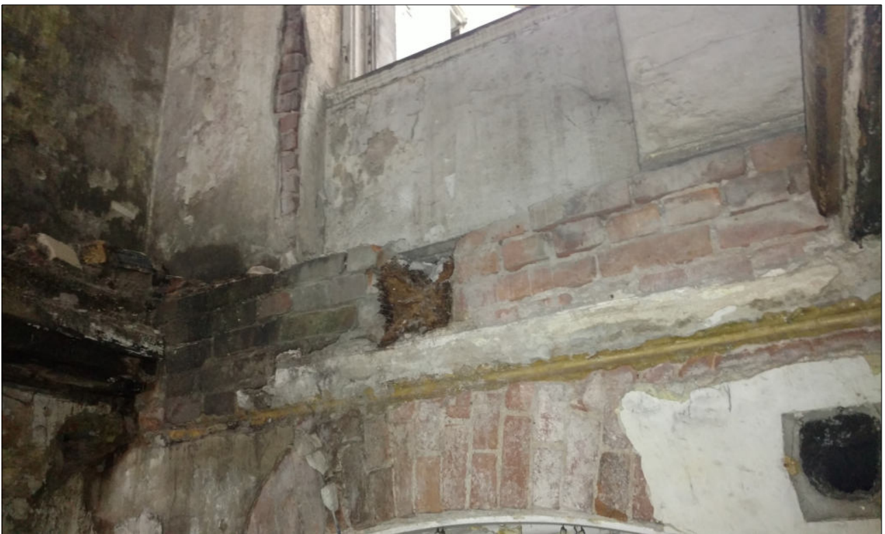
Fot. 46,47. Widok otwartego stropu nad parterem, widoczne elementy konstrukcyjne stropu – belki, drewno o dużym zawilgoceniu, stan mokry, brak impregnacji elementów drewnianych, belki w gniazdach całkowicie przegniłe. Widok gniazda belki drewnianej w murze, nastąpiło ścięcie belki w tym miejscu, silne zawilgocenie murów, a tym samym belek w gniazdach. Stropy do całkowitej wymiany na nowe typu WPS.
