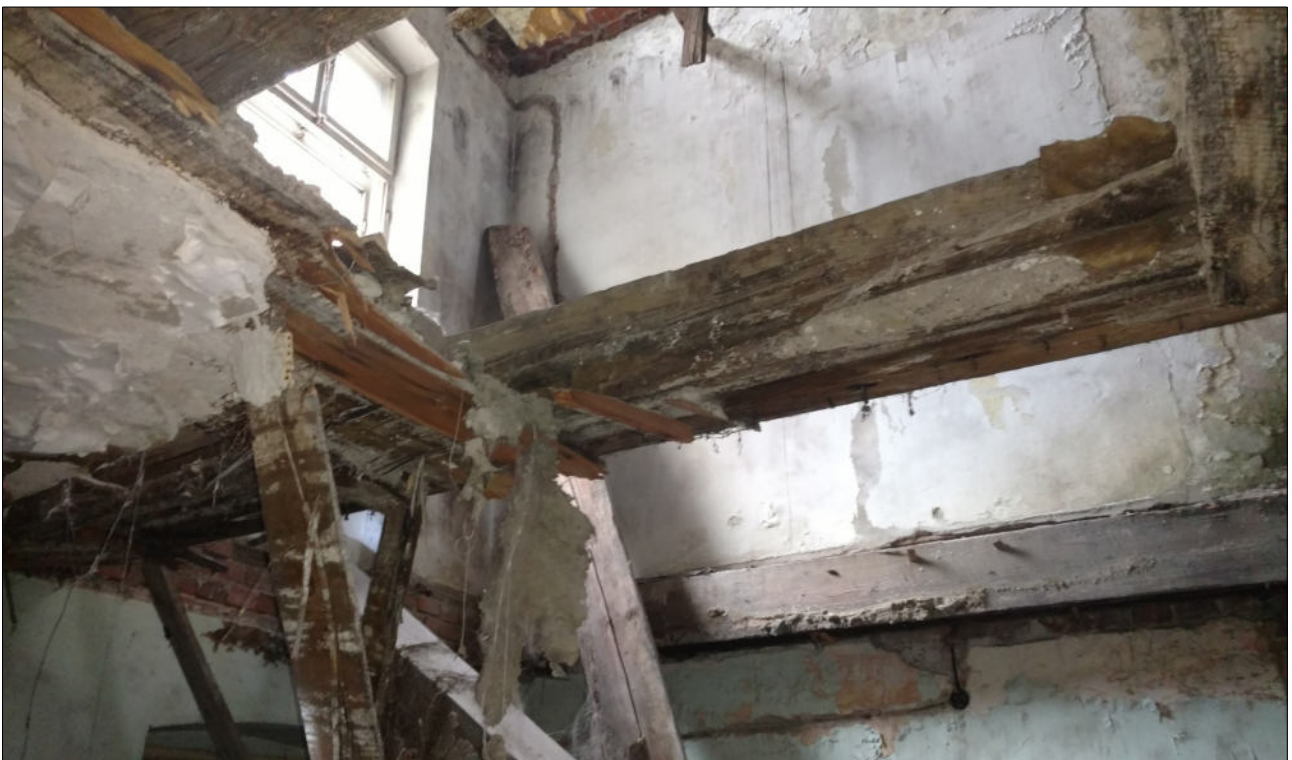
Fot. 40,41. Widok załamane go stropu nad pierwszą kondygnacją, belki konstrukcyjne stropu zostały ścięte w gniazdach muru ceglanego, całość stropu runęła na strop poniżej, nad parterem, w wyniku zarwania się części stropu wystąpiło kolejne zagrożenie dotyczące nośności i wytrzymałości stropu nad parterem – całość materiału ze stropu nad pierwszym piętrzem obecnie niekontrolowanie zalega na stropie nad parterem. Należy w trybie pilnym usunąć całość zgromadzonego materiału na stropie nad parterem, zagrożenie kolejną awarią stropu.
