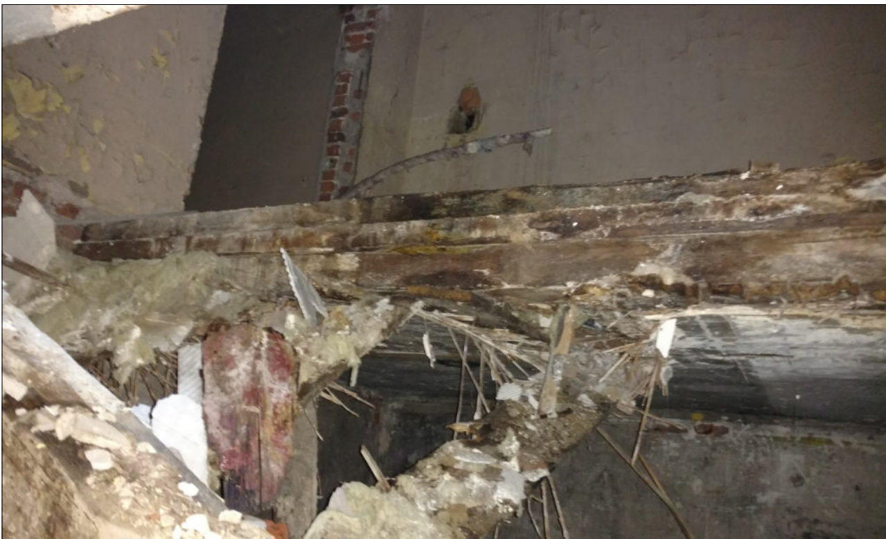
Fot. 42. Widok przekroju stropu po załamaniu się części konstrukcji drewnianej, belki nośne całkowicie porażone korozją biologiczną oraz zmurszałe, drewno całkowicie przegniłe, brak odpowiedniej nośności belek spowodowane jest utratą właściwości drewna wskutek czynników atmosferycznym – w szczególności wody opadowej, która doprowadziła do całkowitego zawilgocenie drewna.
