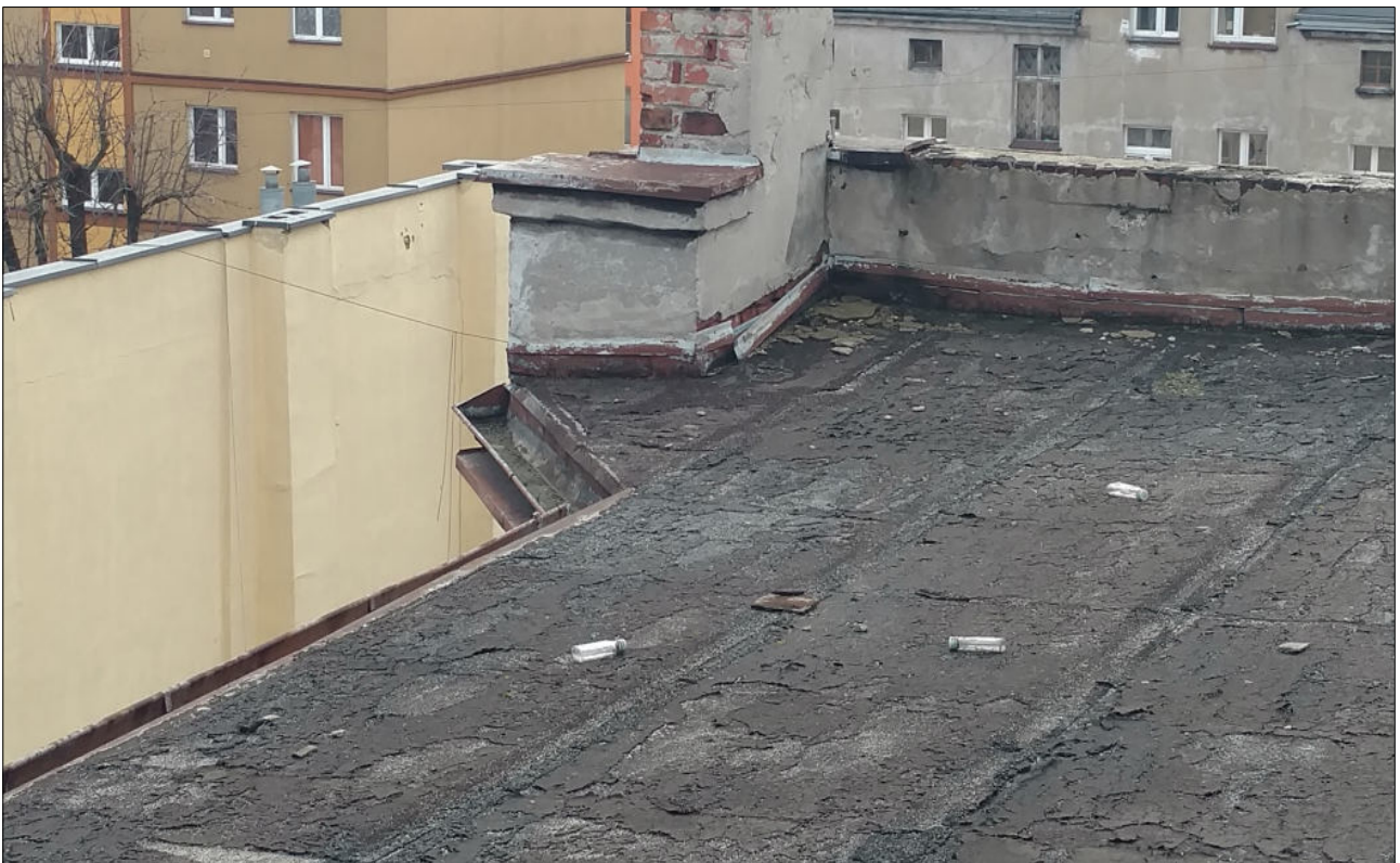
Fot. 30,31. Widoczne pęknięcia trzonów kominowych, brak odpowiednich i szczelnych obróbek blacharskich na połąci dachu (pasy pod i nad rynnowe, obróbki ogniomurów, kominów itp.). Wszystkie elementy obróbek do wymiany na nowe, wykonane z blachy tytan-cynk. Stan techniczny obecnych obróbek blacharskich, rynien i rur spustowych określa się jako zły, zużycie całkowite.
