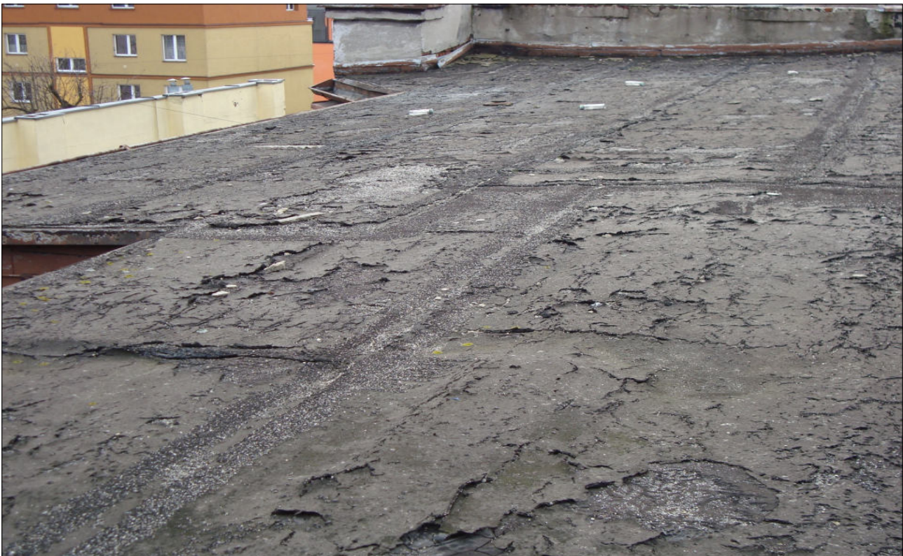
Fot. 24,25. Widok połaci dachu, liczne zapadnięcia deskowania połaci, pokrycie z papy całkowicie zniszczone, niespełniania żadnych już swoich właściwości, deskowanie i konstrukcja dachu zagraża bezpieczeństwu potencjalnemu użytkownikowi, elementy drewniane silnie porażone przez korozję biologiczną i całkowicie zmurszałe wskutek wody opadowej, nie nadają się do dalszej eksploatacji, do całkowitej wymiany na nowe.
