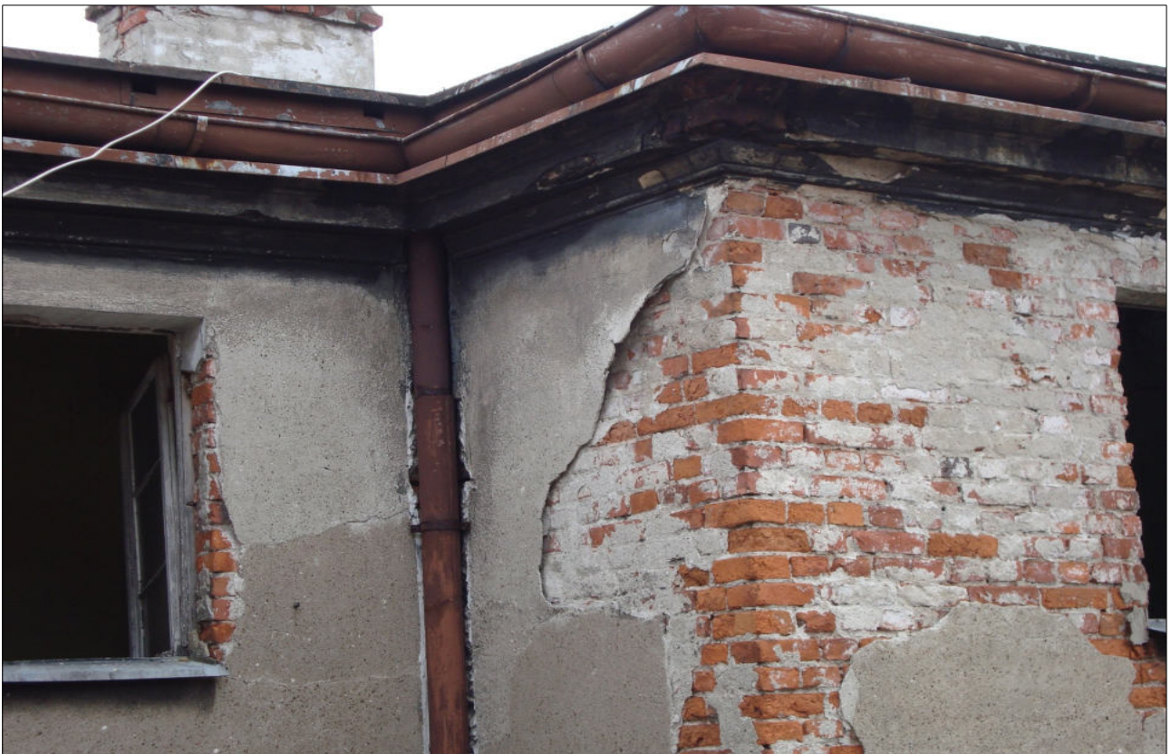
Fot. 3. Elewacja od strony dziedzińca – narożnik budynku, widoczne duże płyty tynku na elewacji, które mogą w każdej chwili odpaść z dużej wysokości, zagraża do bezpośrednio życiu i zdrowiu potencjalnych osób przebywających w pobliżu budynku.
