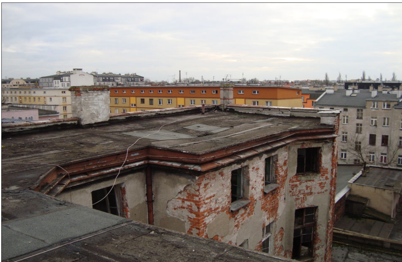
Fot. 23. Widok połaci dachu budynku oficyny – pokrycie dachu w postaci papy na deskowaniu, widoczne liczne zapadnięcia deskowania dachowego, liczne przecieki, stan techniczny konstrukcji dachu i pokrycia – zły, zużycie 100%. Woda opadowa bezpośrednio przenika przez połać do wnętrza budynku.
