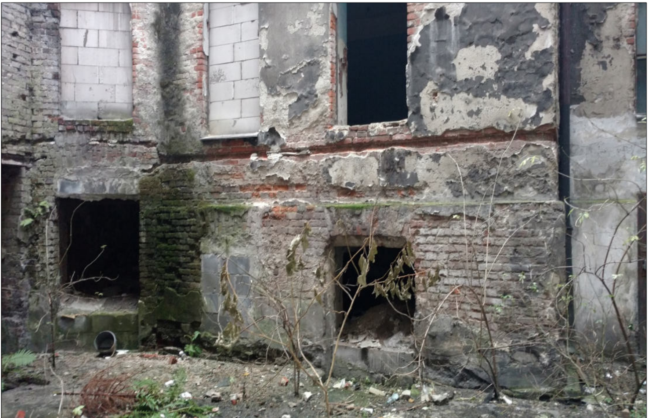
Fot. 5. Elewacja od strony dziedzińca – bardzo duża korozja biologiczna muru ceglanego, widoczne liczne zawilgocenia muru poprzez wody opadowe, podciąganie kapilarne i poprzez zacieki po elewacji, brak odpowiednich obróbek blacharskich, tynki na elewacji całkowicie zdegradowane, część elewacji porośnięta glonami i porażona grzybami pleśniowymi.
