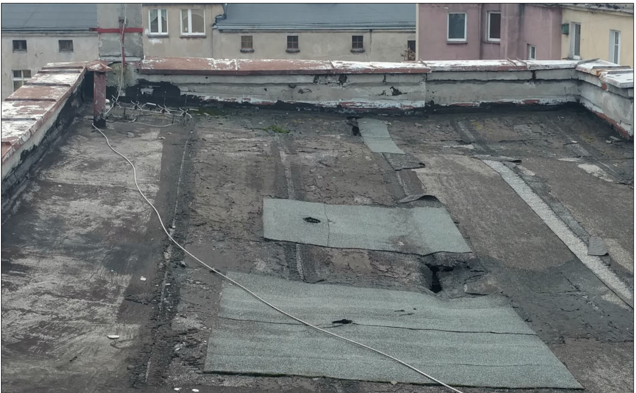
Fot. 28,29. Widoczny zły stan techniczny kominów ponad połacią dachową, ubytki w tynku i cegle, brak szczelnych obróbek wokół kominów, uszkodzone obróbki blacharskie na ogniomurach, widoczne prowizoryczne naprawy połaci dachu (miejscowe łatanie dziur papa), konstrukcja więźby dachowej całkowicie zniszczona, brak dostępu na poddasze budynku – brak schodów, połac dachu zagraża bezpieczeństwu mienia i zdrowia osób tam wchodzących, możliwe zawalenia całej konstrukcji wskutek utraty stateczności więźby – degradacja drewna.
