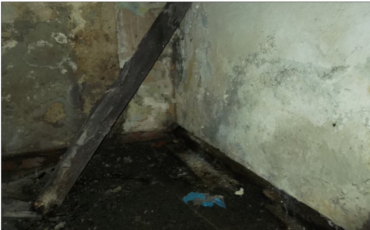
Fot. 16. Przyziemie budynku – widoczne silne zagrzybenie pleśniowe wewnątrz budynku, brak izolacji ścian fundamentowych i posadzki przyczyną silnego podciągania kapilarnego wody opadowej. Podciąganie kapilarne widoczne do kilkudziesięciu cm nad poziomem posadzki. Tynki wewnątrz budynku także całkowicie zdegradowane, mury do osuszenia, odgrzybienia, należy wykonać tynki renowacyjne w strefie przyziemia.
