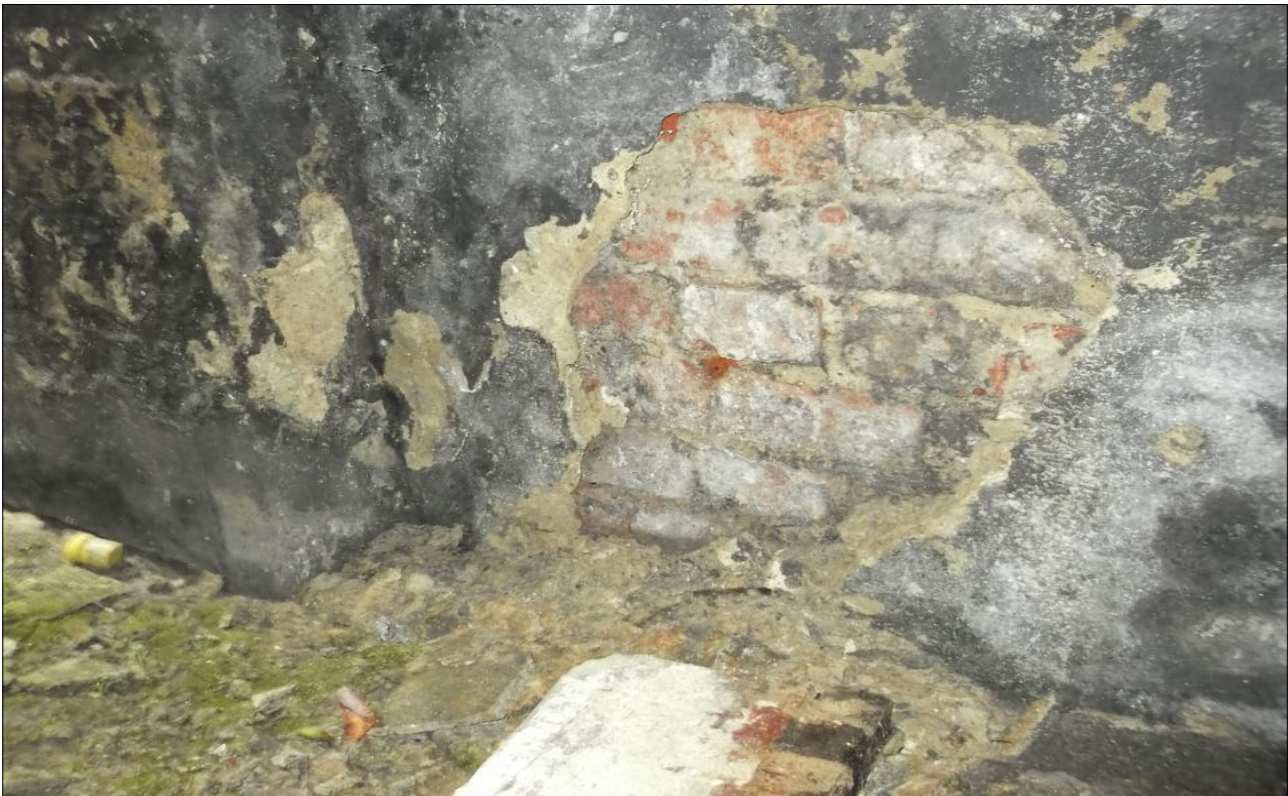
Fot. 15. Mur ceglany w strefie przyziemia – brak izolacji ścian fundamentowych powoduje podciąganie kapilarne wody opadowej, degradacja muru ceglanoego związana jest z znaczną korozją biologiczną, należy wykonać odpowiednie izolacje pionowej i poziome budynku.
