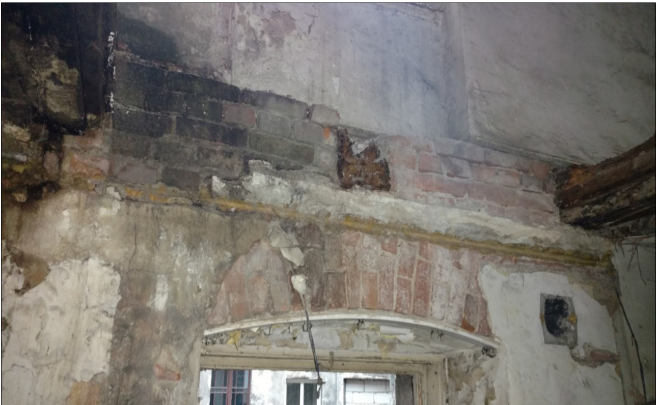
Fot. 35,36. Widoczne zniszczenie elementów przegród budowlanych – zawalenie się części ściany wewnątrz budynku, widoczne zawalenie się części stropu (ścięcie belki drewnianej w gnieździe w murze), całkowita degradacja i korozja biologiczna drewnianych elementów konstrukcyjnych stropu. Dodatkowo materiały budowlane ze stropów i ścian zalegają wewnątrz budynku, co powoduje znaczne obciążenie innych stropów.
