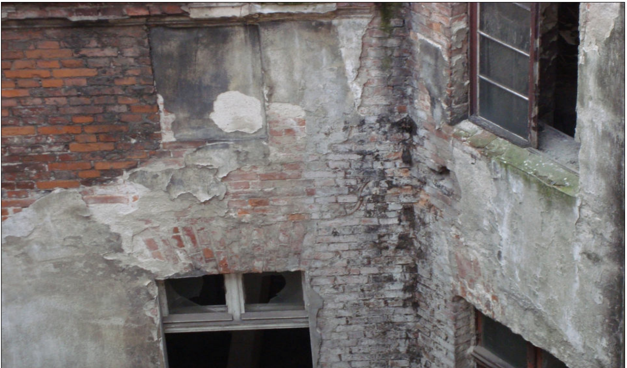
Fot. 4. Elewacja od strony dziedzińca – widoczne silne zmurszenie murów ceglanych, cegłą zawilgocona, porażona korozją biologiczną, brak stolarki okiennej lub stolarka zdekompletowana, brak obróbek blacharskich – parapetów zewnętrznych.
