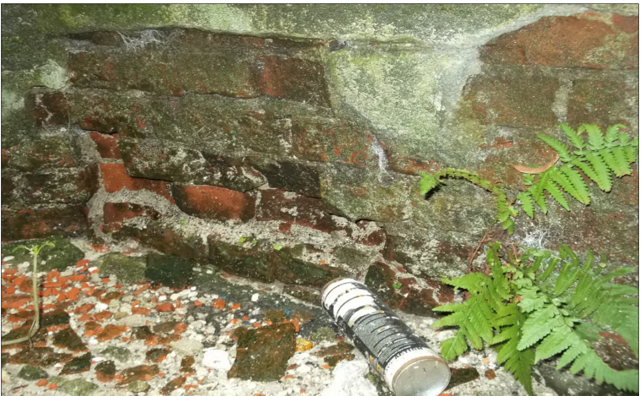
Fot. 9,10. Elewacja budynku w strefie przyziemia – widoczna znaczna degradacja muru ceglanego wskutek korozji biologicznej i podciągania kapilarnego wody opadowej, zmurszenie cegły, które powoduje osłabienie konstrukcji muru, ściany w strefie przyziemia do przemurowania i wzmocnienia, należy wykonać izolację pionową i poziomą ścian fundamentowych wraz z izolacją cieplną.
