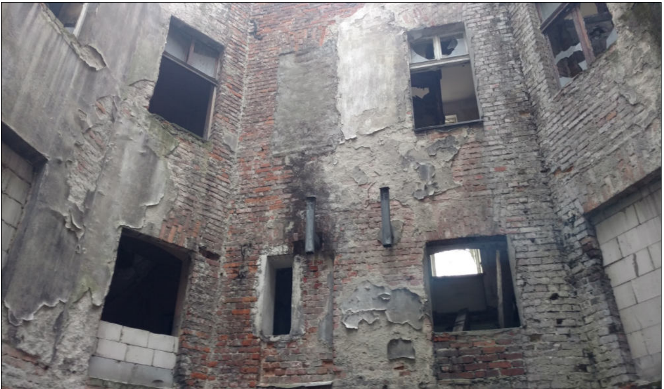
Fot. 2. Elewacja od strony dziedzińca – liczne odspojenia tynków, prowizoryczna wentylacja wywiewna z pomieszczeń, brak stolarki okiennej, znaczna degradacja murów ceglanych – elewacja silnie zawilgocona i porażona przez korozję biologiczną.
