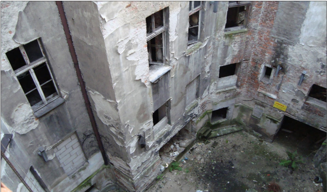
Fot. 1. Elewacja od strony dziedzińca – widoczne liczne uszkodzenia i odparzenia tynku na elewacji, tynk odspaja się od ściany zewnętrznej budynku, może zagrażać bezpieczeństwu życia i zdrowia osób tam przebywających, brak w większości stolarki okiennej, zdekompletowana lub całkowicie zdemontowana.
