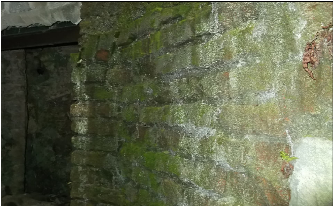
Fot. 13,14. Elewacja budynku w strefie przyziemia – degradacja mury wskutek silnego zawilgocenia oraz korozji biologicznej, cegła w strefie przyziemia w znacznym stopniu murszała, stan wilgotności mokry, widoczne także sine wykwity solne na murze.
