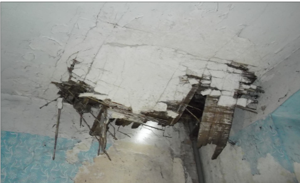
Fot. 43. Widok podsufitki stropu nad parterem, widoczne uszkodzenia elementów drewnianych w wyniku silnego zawilgocenia, a tym samym dużej korozji biologicznej, belki drewniane w gniazdach w murze silnie przegniłe, w każdej chwili może dojść do ścięcia belek w gniazdach.
