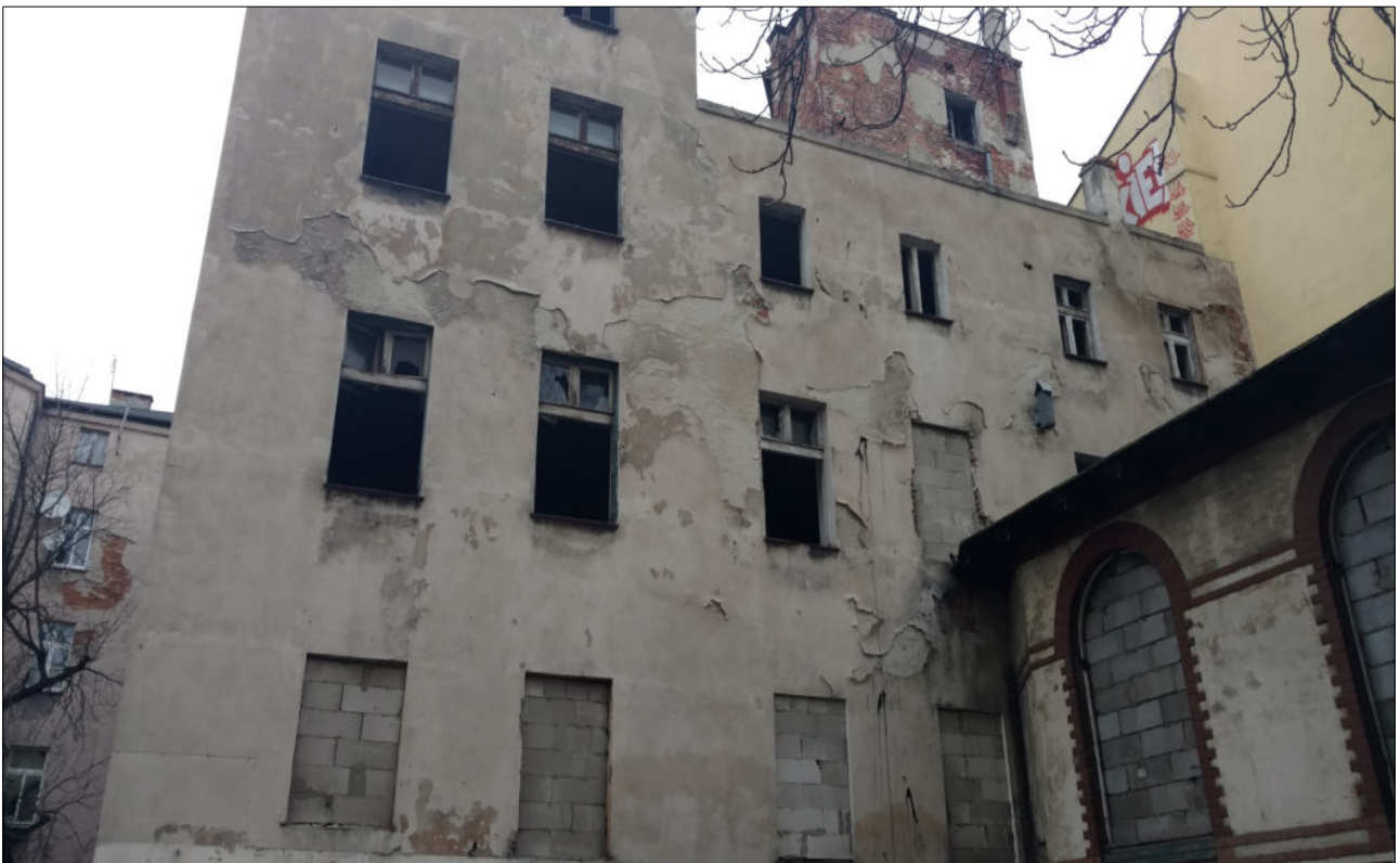
Fot. 6. Elewacja od strony frontowej oficyny – widoczne zamurowania otworów okiennych w poziomie parteru, zabezpieczenie przed wejście do budynku osób nieuprawnionych. Brak stolarki okiennej, tynk na elewacji zdegradowany poprzez wody opadowe, mocno zawilgocony.
