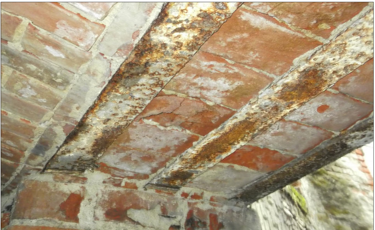
Fot. 48,49. Widok stropu nad częścią przyziemia, strop typu Kleina, widoczna korozja belek stalowych, należy wykonać naprawę stropu zgodnie z zapisami z opracowania, strop w stanie średnim, nie zagraża bezpieczeństwu użytkowania.
