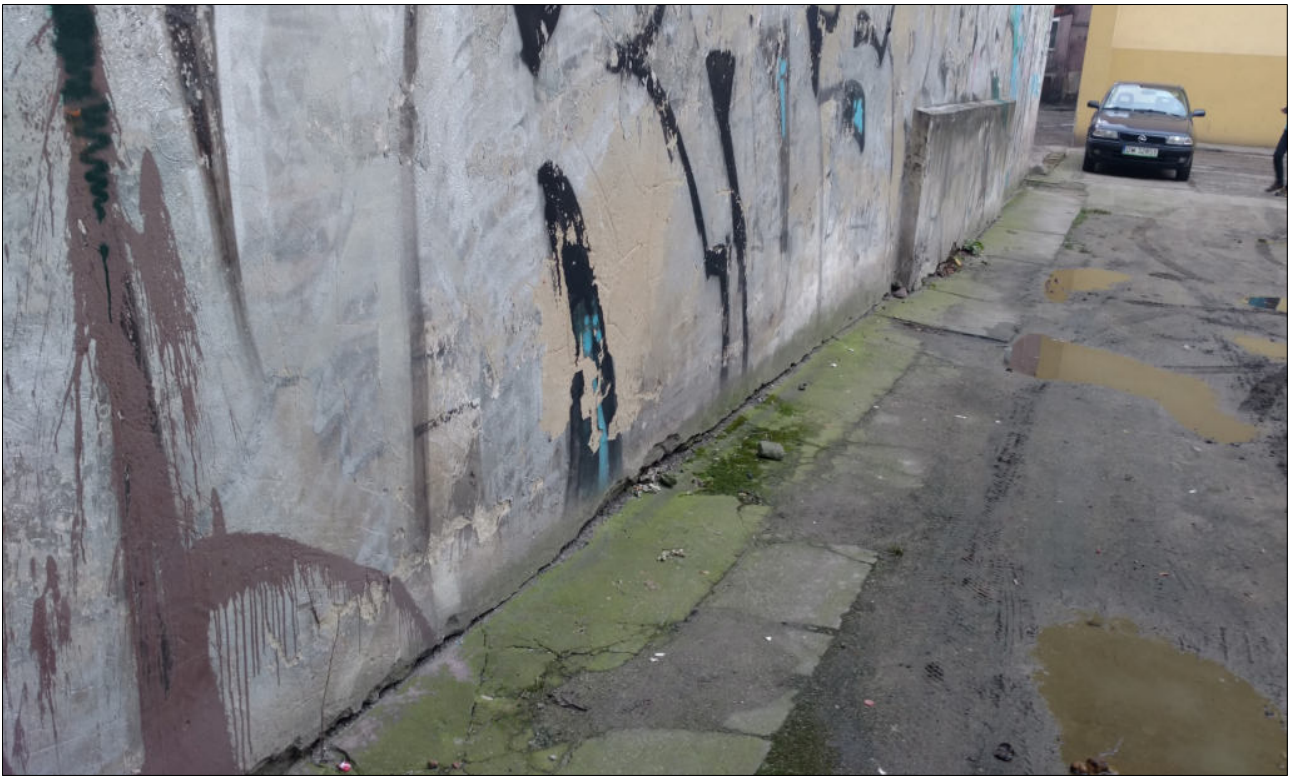
Fot. 11. Elewacja boczna budynku – widoczne uszkodzenia opaski betonowej wokół budynku, brak izolacji pionowej i poziomej ścian fundamentowych, widoczne podciąganie kapilarne muru ceglanego, należy wykonać izolację zgodnie z wytycznymi.
