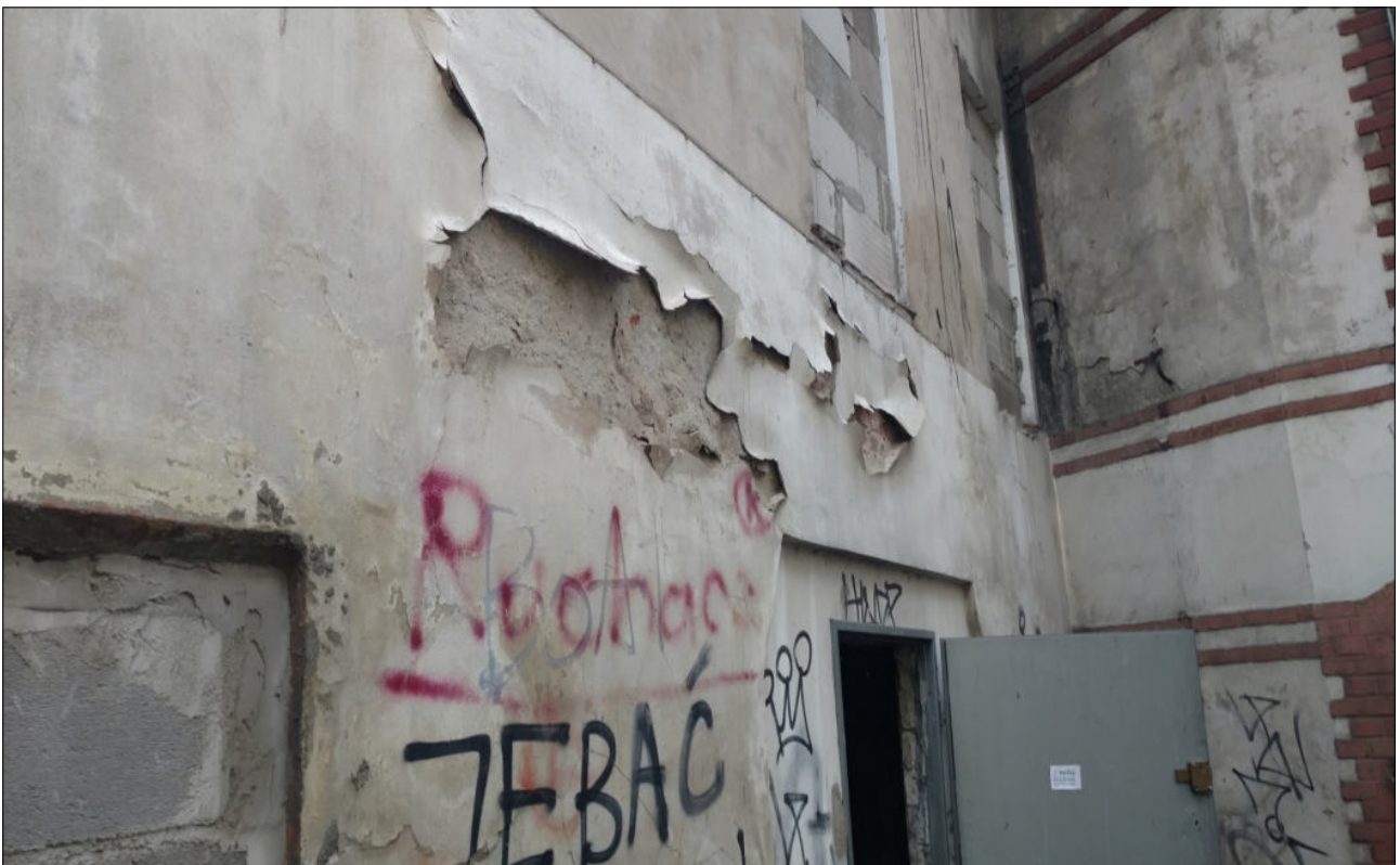
Fot. 7,8. Elewacja od strony frontowej oficyny – widok elewacji, liczne odspojenia tynków wskutek zmurszenia murów ceglanych jak i samych tynków, brak widocznych większych pęknięć ścian zewnętrznych budynku, elewacja do generalnego remontu i docieplenia, brak odpowiedniej izolacyjności przegród zewnętrznych (ściany, stolarka okienna, stropodach).
