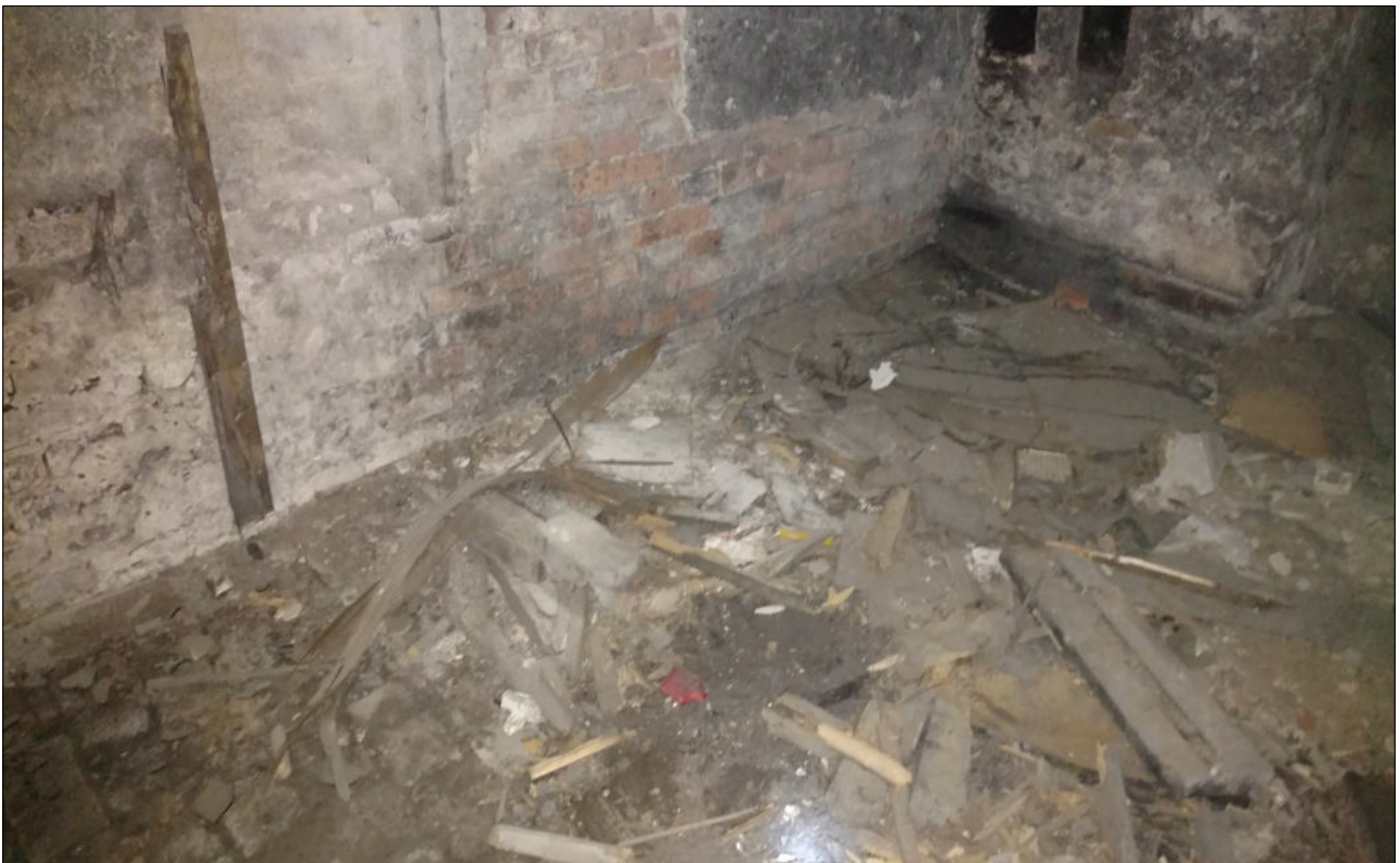
Fot. 21,22. Wnętrze pomieszczeń budynku w przyziemiu, brak izolacji posadzek i ścian fundamentowych – degradacja całości elementów wykończeniowych budynku, stan techniczny zły, stopień zużycia 100% - posadzki i podłogi, tynki wewnętrzne.
