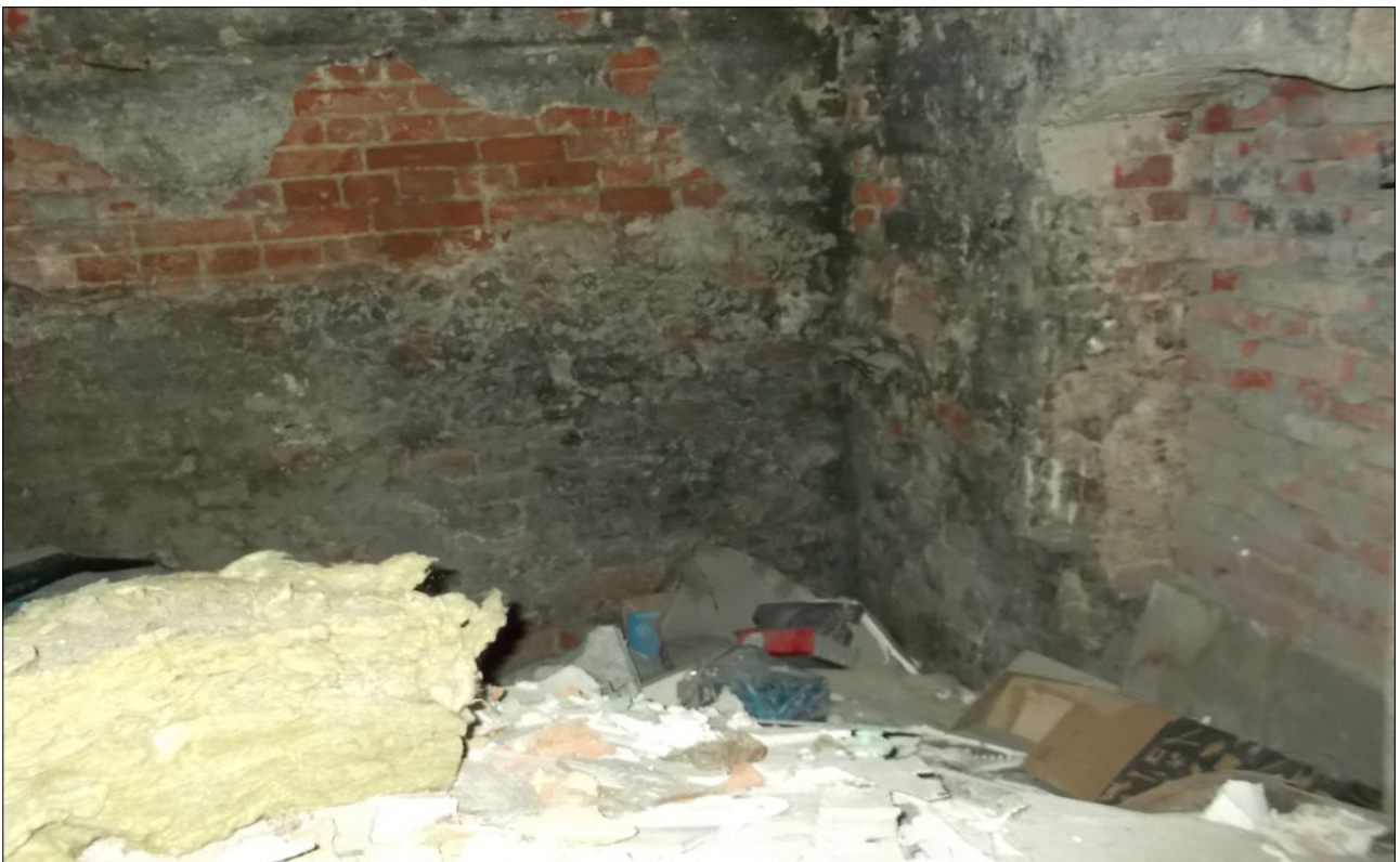
Fot. 19,20. Widok wewnątrz pomieszczeń w poziomie przyziemia, całkowita degradacja tynków, podłóg, posadzek i innych elementów wykończeniowych budynku, stan techniczny zły, elementy nie nadają się do dalszej eksploatacji, należy wykonać całkowity demontaż podłóg i posadzek, skucie całości tynków. Zagrzybienie pleśniowe zagraża życiu i zdrowiu potencjalnie tam przebywających osób.
