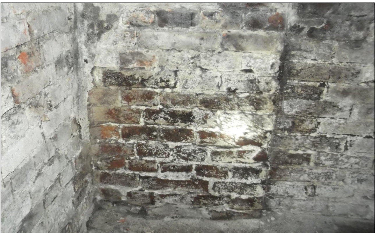
Fot. 17,18. Przyziemie budynku – widoczne silne wysolenia na murze ceglanym, stan muru określa się jako mokry, silne zagrzybenie pleśniowe wewnątrz pomieszczeń, mury nadają się do generalnego remontu (odgrzybienie, osuszenie, izolacja, tynki renowacyjne, miejscowe wzmocnienie).
