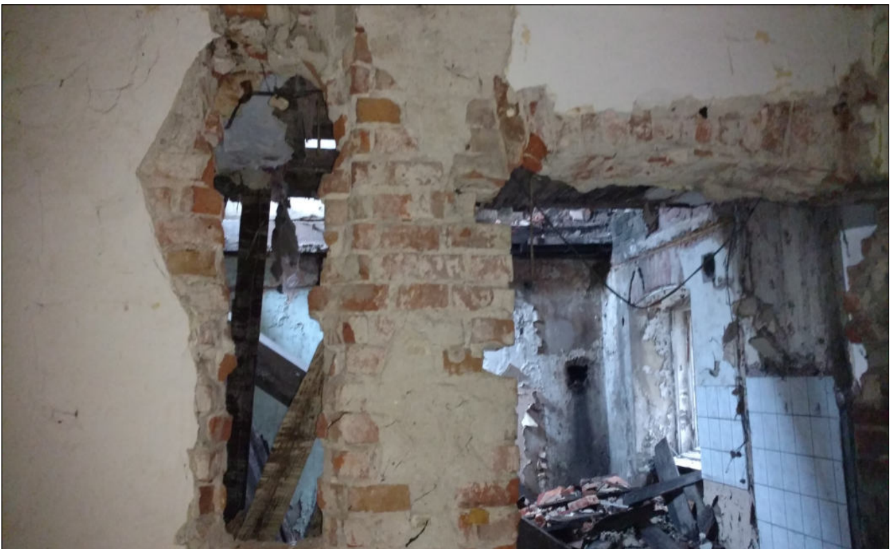
Fot. 33,34. Widoczne braki w elementach konstrukcyjnych budynku – brak nadproży i podciągów, elementy stalowe w części zdemontowane przez złomiarzy, brak odpowiedniego przesklepienia otworów drzwiowych i przejść. Brak zdemontowanych elementów konstrukcyjnych powoduje realne zagrożenie dla stateczności ścian konstrukcyjnych, należy w trybie pilnym zabezpieczyć owe miejsca poprzez podstemplowanie zagrożonych miejsc. Obecnie konstrukcja budynku narażona jest znacznie na awarię lub katastrofę budowlaną.
