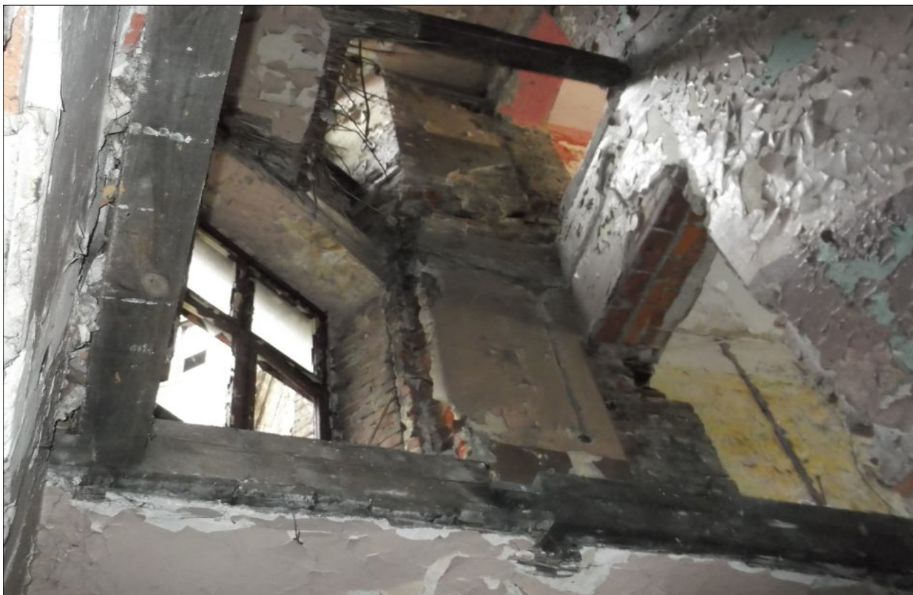
Fot. 39. Widok zdemontowanych biegów klatki schodowej, brak dostępu do wyższych pięter budynku, pozostawione elementy biegów schodów zagrażają bezpieczeństwu życia i zdrowia osób przebywających osób w pobliżu – możliwość niekontrolowanego oderwania części pozostawionych elementów budowlanych, deski, belki itp.
