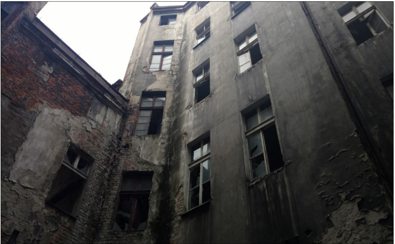
Fot. 6. Elewacja od strony dziedzińca – bardzo duża korozja biologiczna muru ceglanego, widoczne liczne zawilgocenia muru poprzez wody opadowe - poprzez zacieki po elewacji, brak odpowiednich obróbek blacharskich, tynki na elewacji całkowicie zdegradowane.
